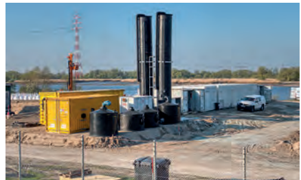
Wasserfilter stehen an Ort und Stelle
